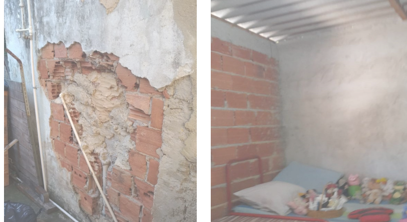
Ausência de revestimento interno, Fonte: Autores, 2022
