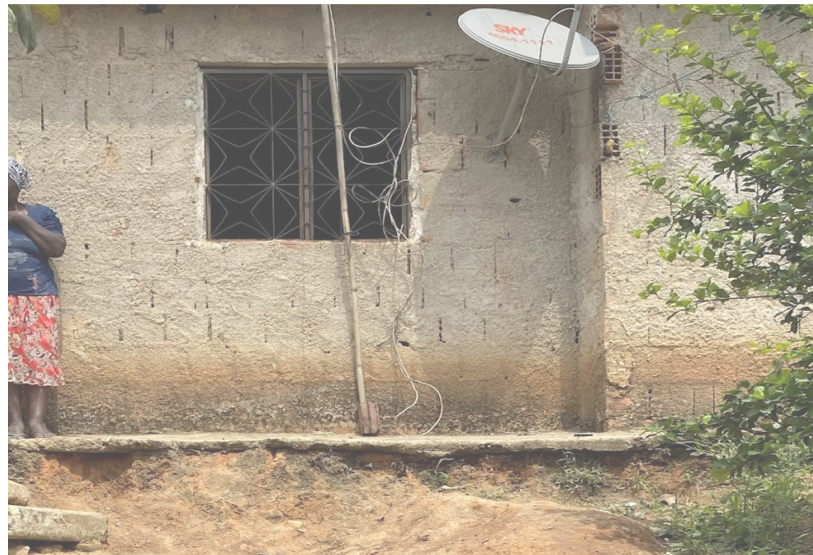
Ausência de revestimento externo, Fonte: Autores, 2022
