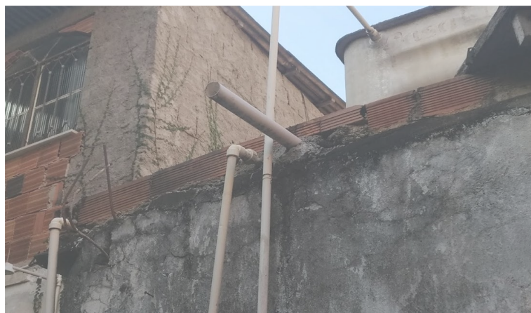
Coberturas mal posicionada, Fonte: Autores, 2022
