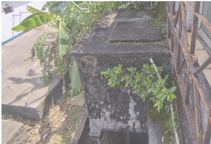
Caixa D'água comprometida, Fonte: Autores, 2022
